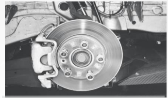
Starke Abnutzung von Verschleißteilen
