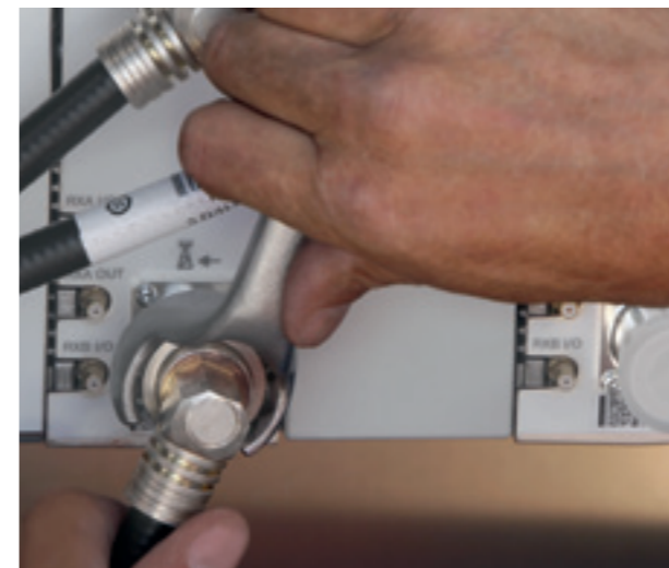
Sendetechnik: Die massiven Zuleitungskabel zu den Funkantennen werden wieder am neu installierten Modul angeschlossen.
